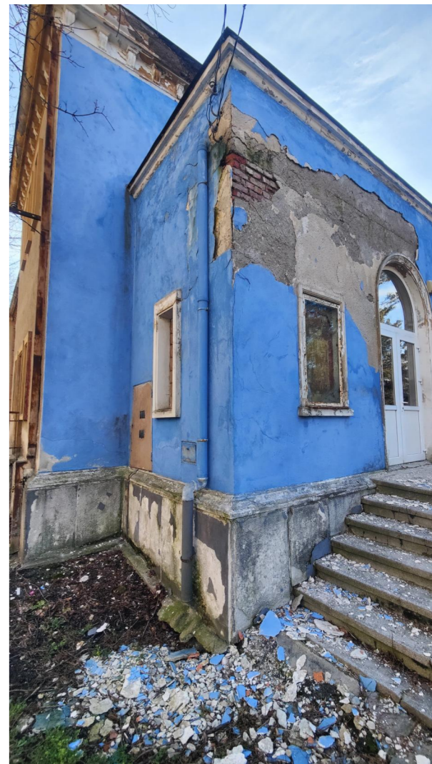
stare de degradare avansată la toate părțile constructive ale clădirii
