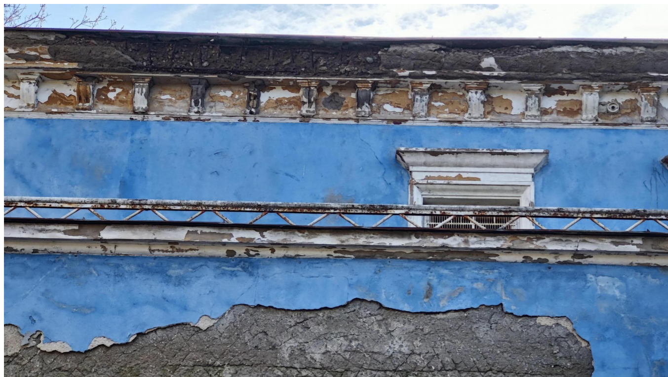
Starea actuală a profilului cornișei deteriorată
