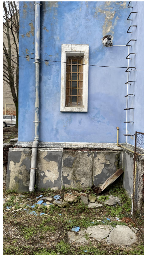
degradări ale soclului cu bosaje
